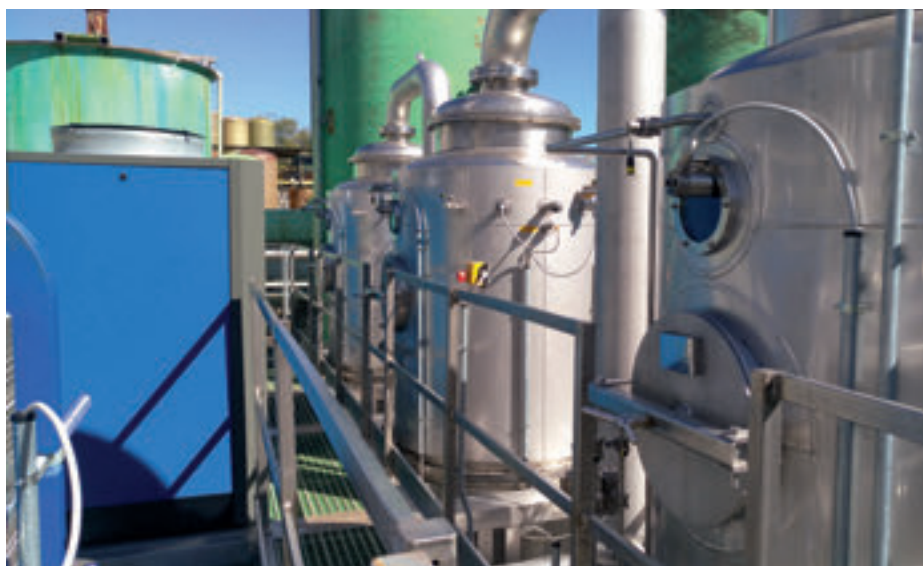
La zona di camminamento che consente di ispezionare l'interno dei vessel evaporativi.
